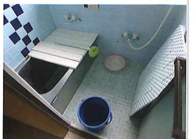
既存の在来浴室。恒常的に漏水しており、軸組の腐食を招いていた
