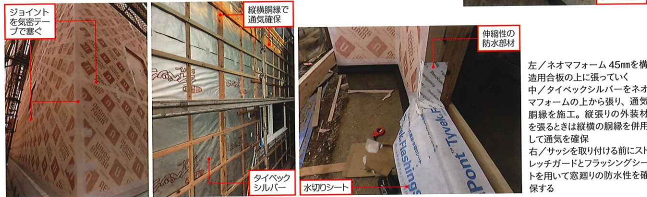
左/構造用合板を軸組の全周に張り、気密テープを貼って気密化する 中/断熱工事に先行して配管や配線のためのスリーブを入れておく 右/外張り断熱の施工に備えて出隅部分に細い合板を張って平らにする。気密テープを貼って気密化
