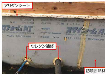
基礎の外側には防蟻断熱材のスタイロフォーム AT50mm厚を使用。貫通部は防蟻剤入りのウレタンフォームで隙間を塞ぐ
