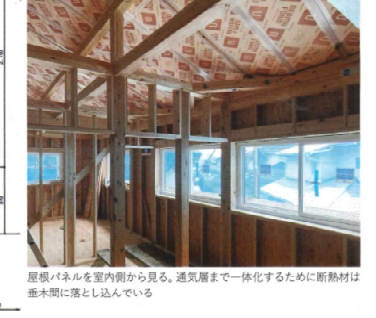
屋根パネルを室内側から見る。透湿層まで一体化するために断熱材は垂木間に落とすし込んでいく
